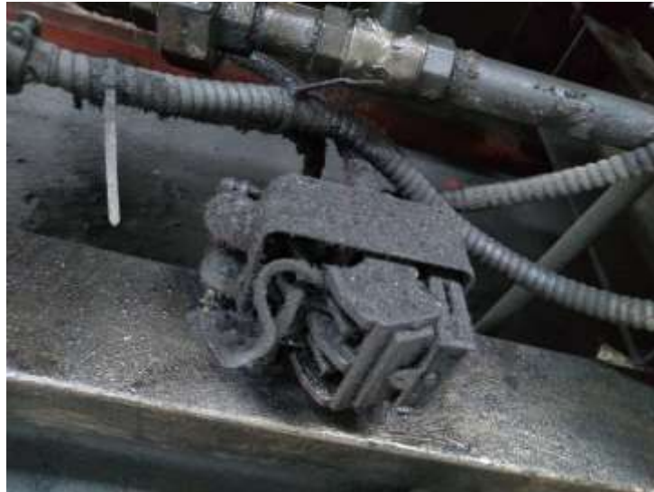
Figura 16 Estado de los conectores de un generador de energía
