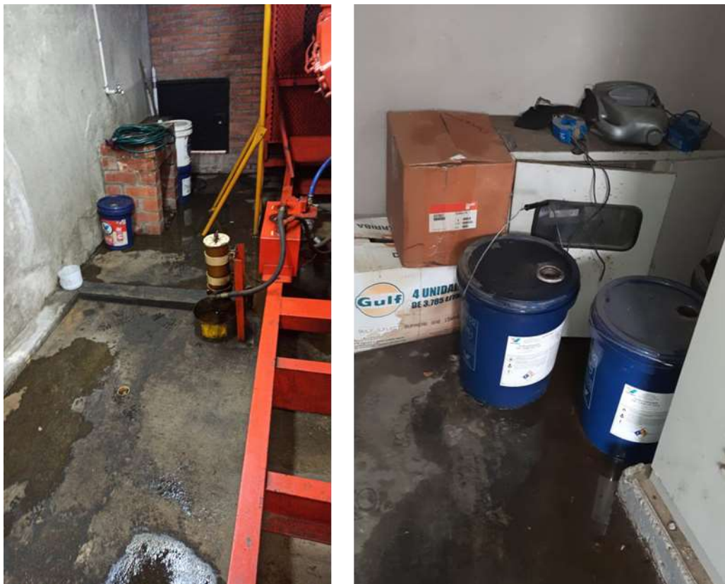
Figura 15 Escenarios de humedad en zonas eléctricas
