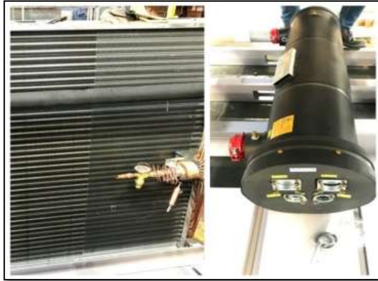
Figura 9 Evaporadores de equipos de climatización
